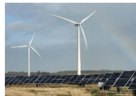
▲ EEが開発した発電設備(デンマーク・ホルメン)
