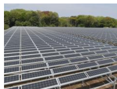
所沢北岩岡太陽光発電所
