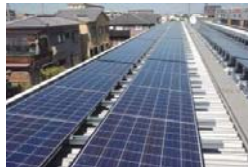
太陽光パネルを設置した集合賃貸住宅の屋根
