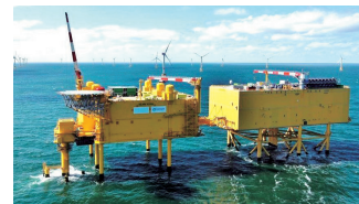
当社が参画する ドイツ海底送電事業の洋上変電所
