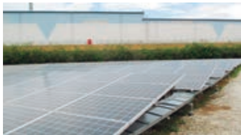
太陽光発電プラント (佐賀県三養基郡)
