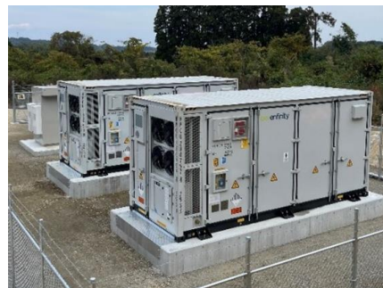
▲ エンフィニティ・ジャパンと共同で運営する九州の蓄電池事業
