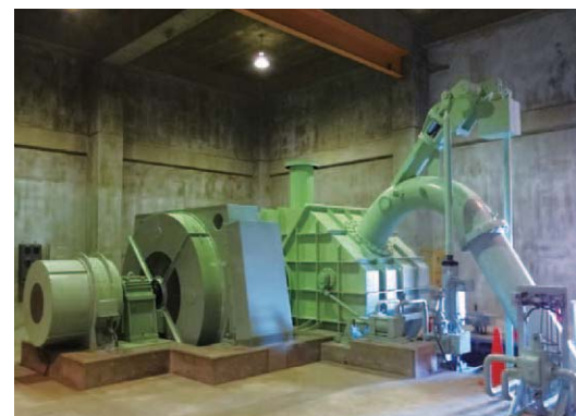
最上川水系の水力発電所内部の様子
