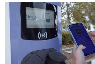
▲ EV充電設備
