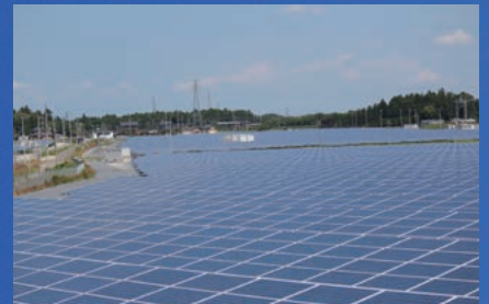
日立グリーンエナジー(有)が運営する、12.7MWの発電容量を有する日立北浦複合団地太陽光発電所
