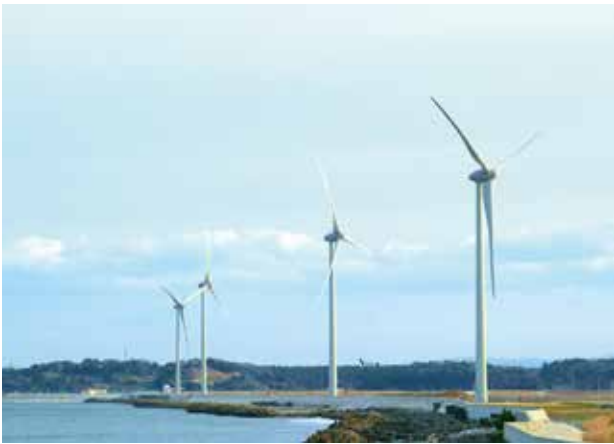
万葉の里風力発電所(福島県)
